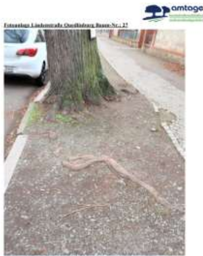
Abb. 36 straßenseitige Hauptwurzel in den Seitenraum ausgewichen
