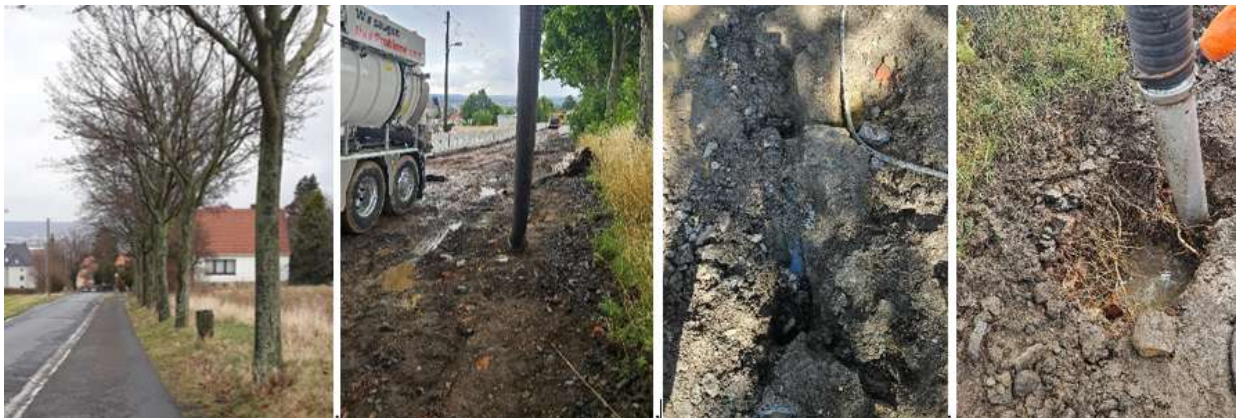
Abb. 50 keine Wurzeln unter den Bitumendecken von Fahrbahn und Gehweg
