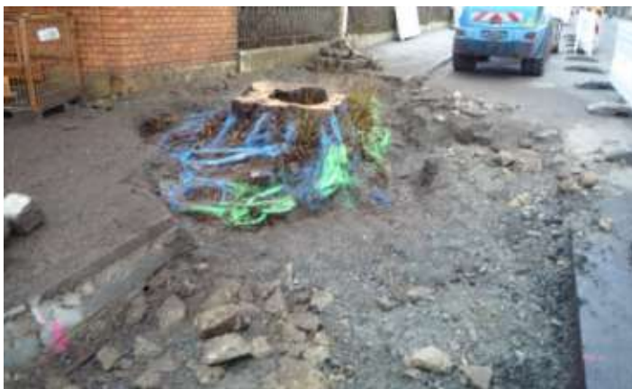
Abb. 52 Wurzel ausbreitung links, seitlich von Fahrbahn weg in Seitenraum hinein
