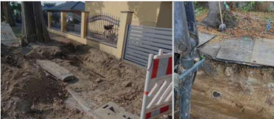
Abb. 48 keine Wurzeln unter der Bitumendecke der Fahrbahn
